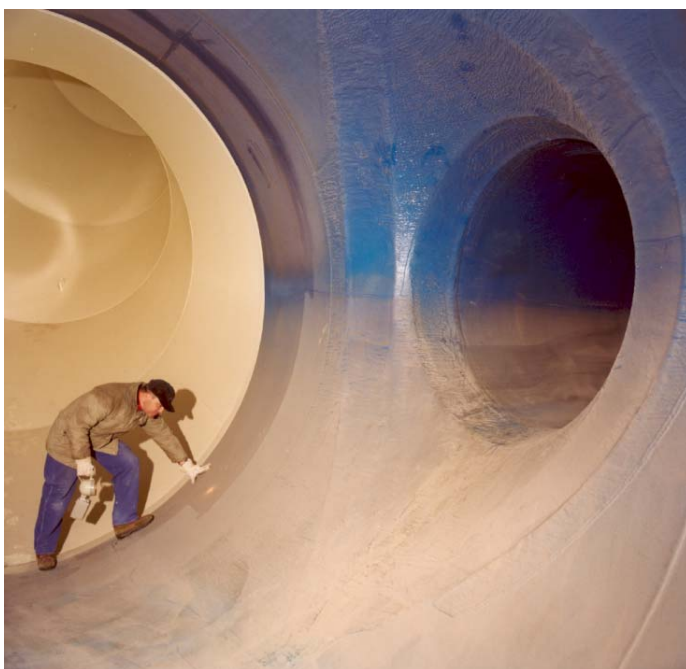
Abb. 4.3.18 Ausführung im WS Kaunertal, Blick in Richtung nach oben aufsteigenden Luftrohr, nach rechts, Einmündung ins Saugrohr der Wirbelstromdrossel [e]
