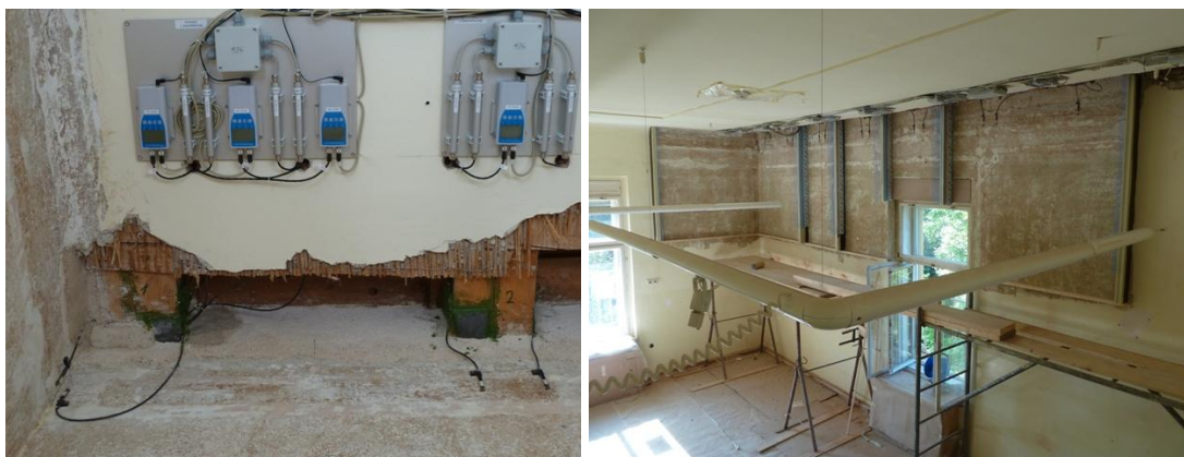
Abb. 9 Zellulose-Messfeld mit abgedichteten Holzfeuchtesensoren (,HF-St'), kombinierten Luftfeuchte / Temperaturfühlern (,ID') und Montageplatten mit der Messelektronik
