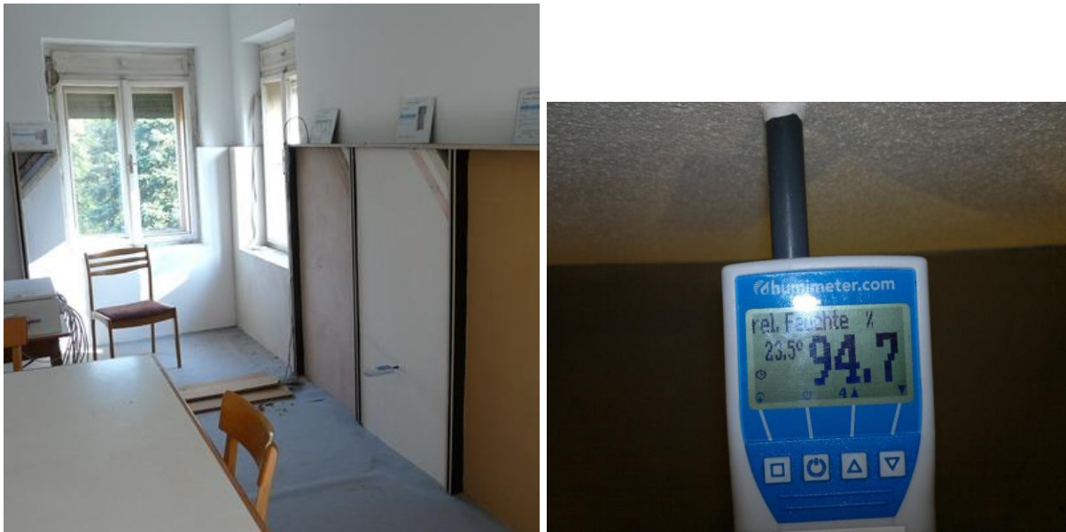
Abb. 56 Ein Handgerät mit Temperatur/Luftfeuchtesensor misst im mit Wärmedämmputz gedämmten Feld die Verhältnisse auf der ehemaligen Bestandsoberfläche
