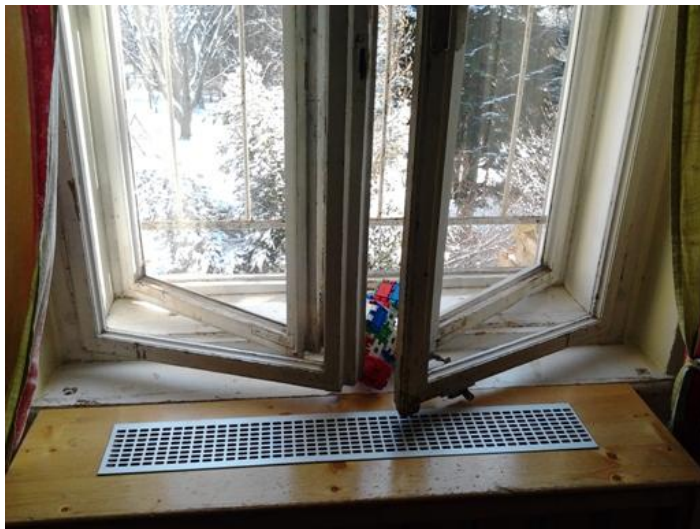
Abb. 51 Eine Figur aus Bausteinen verhindert das Schließen der Fensterflügel im Zimmer des Obergeschosses am 8. Februar 2012
