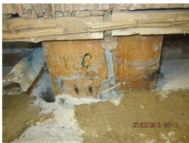
Abb. 32 Holzweichfaserplatte nach Entfernen von Dämmung und Dichtband: Verschluss eines Risses mit einem eingeleimten Holzdübel und dauerelastischer Dichtmasse
