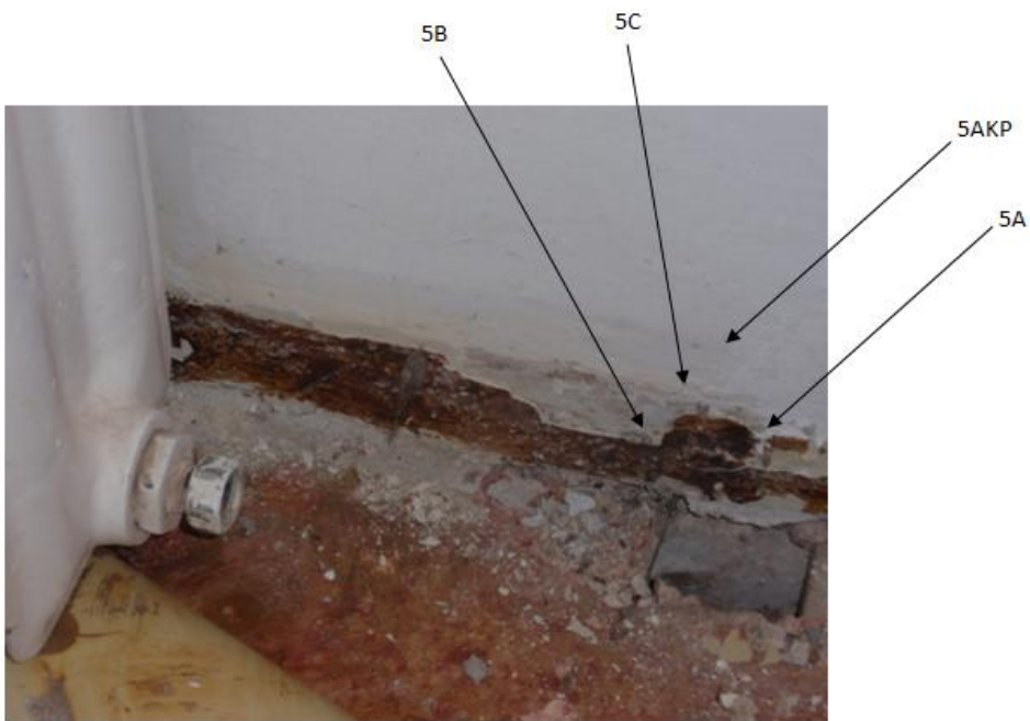
Abb. 118 Foto 5. Probenort 5: Außenwand – linke DG-Raumhälfte im Bereich eines Heizkörperrohres, das in den Boden führte – sehr poröse Wand (feucht)
