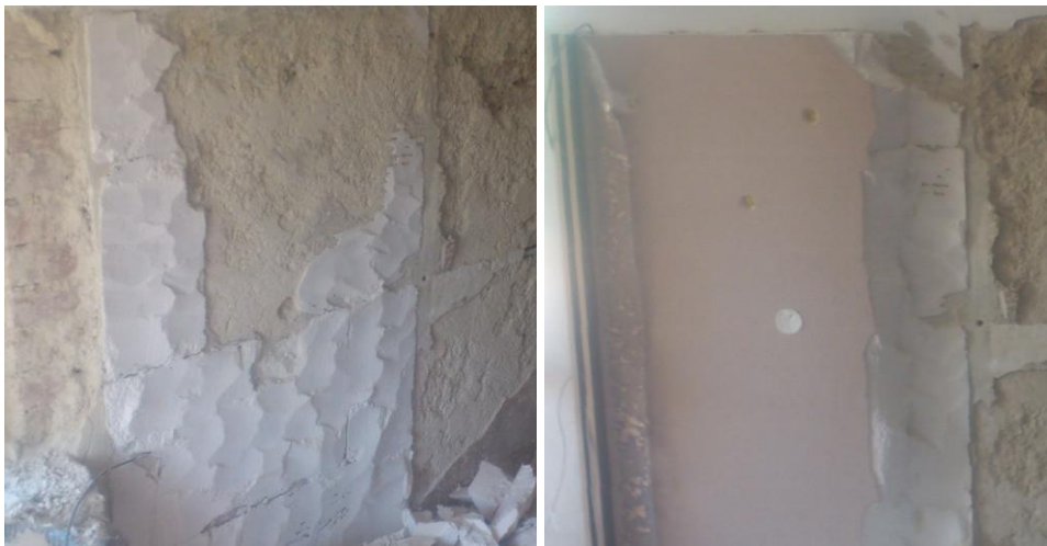
Abb. 27 Abbruch der Perliteplatte: die einzelnen Abscherflächen in der Kleber- und Dämmschicht des Spatens sind links gut zu erkennen
