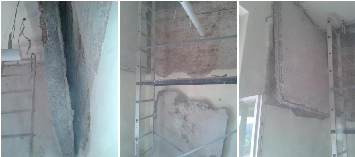
Abb. 26 Abbruch der Zellulosedämmung: die Dämmung löste sich großflächig als ganze Platte mit dem Bestandsputz
