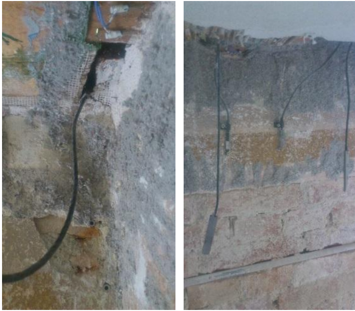
Abb. 33 Zellulosedämmung: links Kabel des rechten Temperatur/Luftfeuchte ‚BA-St‘ Sensor noch in Balkentasche, rechts herunterhängende Kabel der Luftfeuchte-/Temperatur-Sensoren ‚BA-St‘, ‚BA-Wa‘ nach Herausziehen der Sensoren
