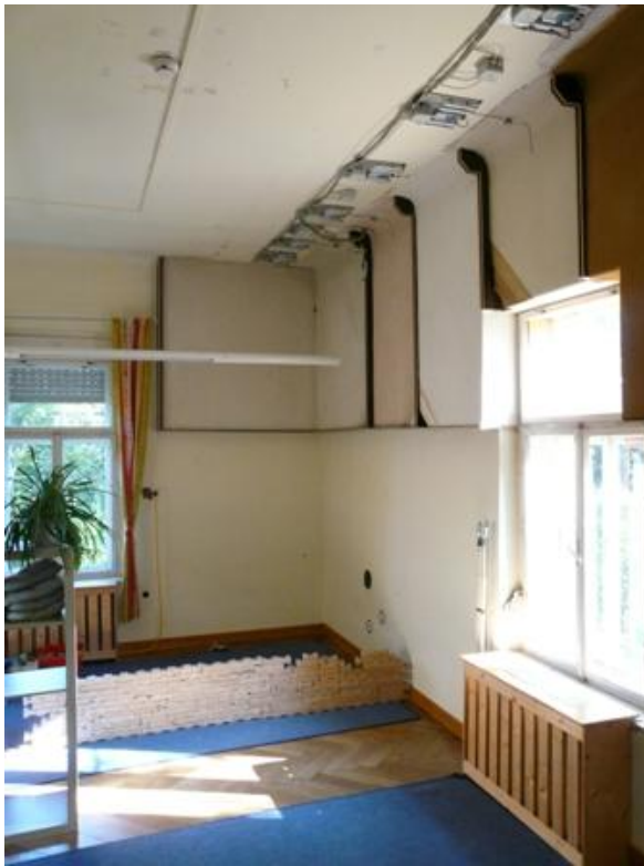
Abb. 20 Gesamtansicht der Dämmsysteme nach Abschluss der Arbeiten im Obergeschoss; von links: Zellulose, Perliteplatte, Thermosilitputz, Holzweichfaserplatten und Schilfmatten
