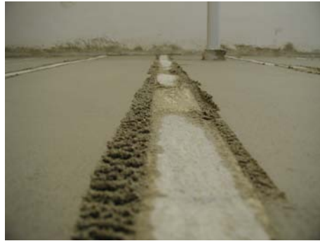
Fig. 24 Probe VI – Probleme beim Verreiben des Grundputzes
